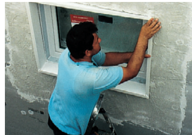
Zusammengesetztes Dämmungsanschlussprofil nach Abschluss der Wandbelagsarbeiten in die durch das Entfernen der Schalungsabdichtung entstandene Nut einsetzen
