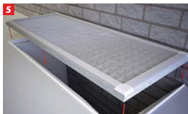
5 Befestigen Sie die Abdeckung am Gitterrost. Zum Abschluss montieren Sie den Rost wie im Ursprungszustand an Ihrem Kellerschacht.
