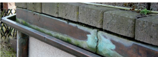
Dachrinnen aus Zink oder Kupfer verwittern schnell und sind schadensanfällig.
