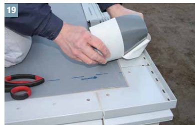
19 Begonnen wird immer an der vordersten/ tiefst gelegenen Traufkante. Zum einfachen Ankleben sind die Abdichtungsbänder mit einer 2-geteilten Silikonfolie ausgestattet.
