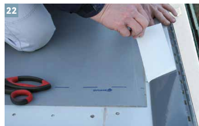
22 Die korrekte Lage der DiProtec® SDB überprüfen, ggf. korrigieren. Jetzt die hintere Hälfte umklappen und wie unter Bild Nr. 21 das DiProtec® AB-K Abdichtungsband ankleben.
