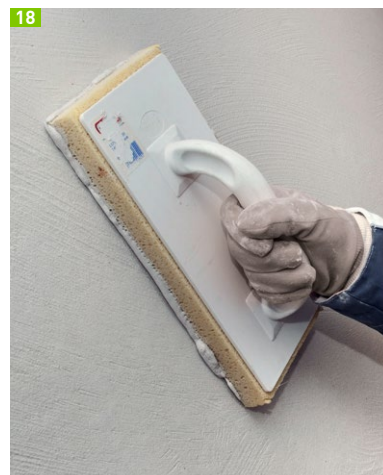
18 Oberputz evtl. abfilzen
