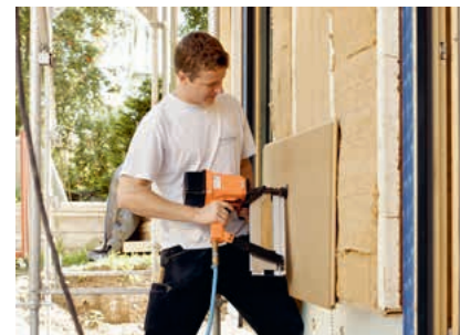
Ausdämmung der Wandgefache mit STEICO flex . Gefachabschluss mit STEICO universal als zweite wasserführende Schicht hinter der Lärchenholzschalung.
