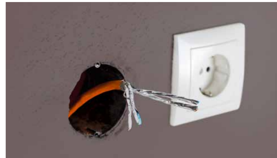
Steckdosen, Durchdringungen und Wandanschlüsse sind luftdicht herzustellen
